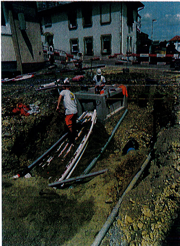
Chambre électrique à la rue du Midi.
