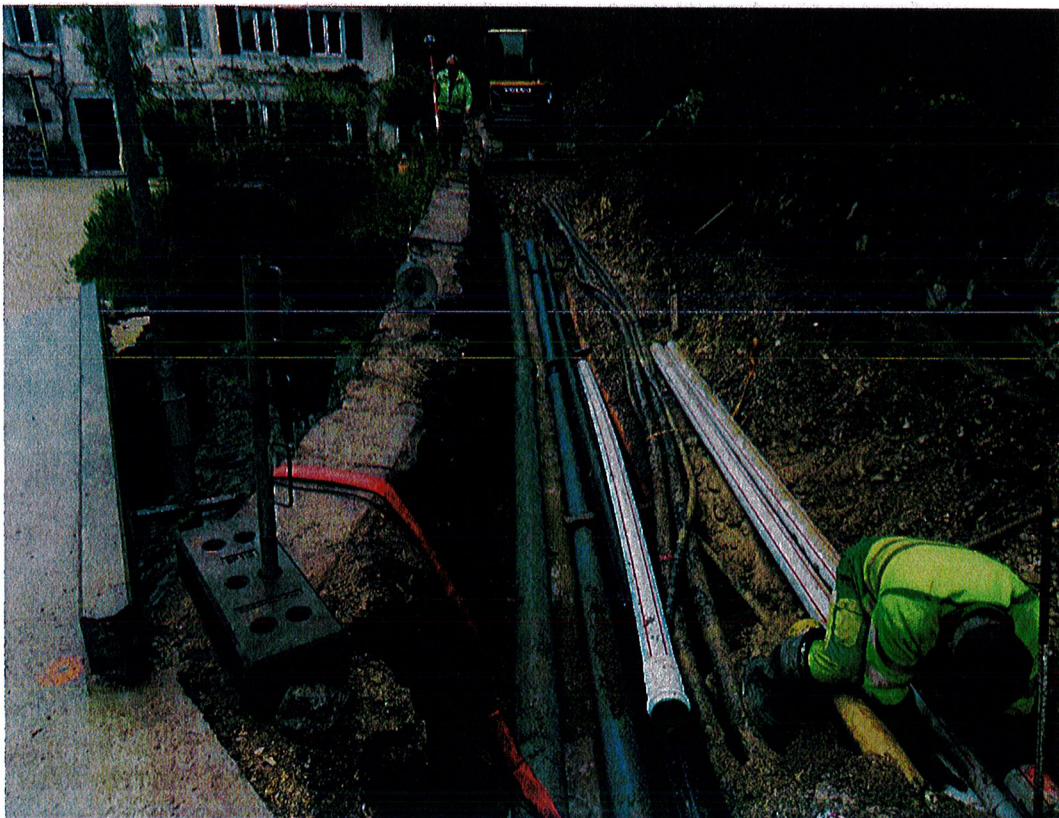
Station de la Raisetette, conduite de secours pour alimenter le réseau de Cormoret.
